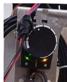
Fig. 3) Grøn og Gul diode bekræfter Servicetilstand
